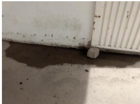
SE OBSERVAN SEPARACIÓN ENTRE PISO EXTERIOR Y MURO DE FACHADA, DE FORMA QUE SE PERMITE EL FLUJO LIBRE DE AGUA A LA CIMENTACIÓN, PROVOCANDO DETERIORO Fuente: Dictamen de estructuras 2020
