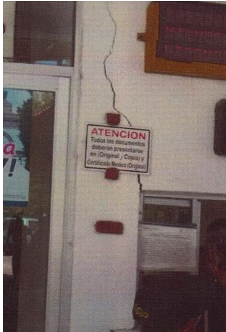
SE OBSERVAN GRIETAS EN MUROS DE FACHADAS Fuente: Dictamen de estructuras 2019
