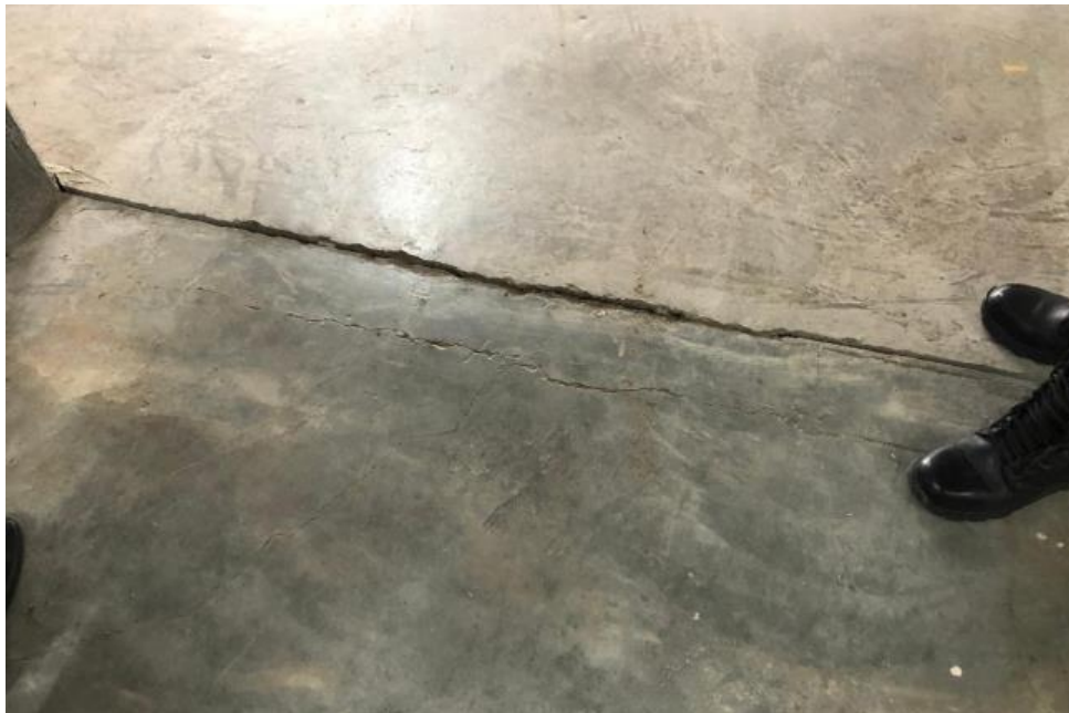
SE OBSERVAN GRIETAS DEBIDO A MALA COMPACTACIÓN O MALA CALIDAD DEL RELLENO. Fuente: Dictamen de estructuras 2020
