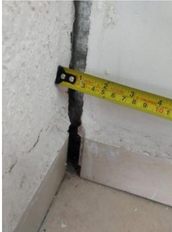
SE OBSERVAN SEPARACIONES DE ELEMENTOS DE 3 CM Fuente: Dictamen de estructuras 2020
