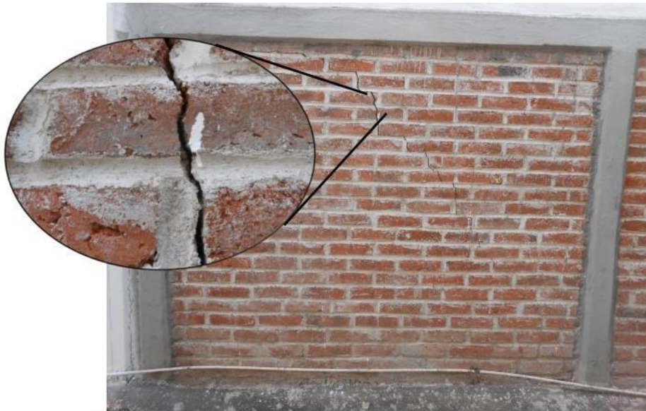
SE OBSERVA MURO DE TABIQUE ROJO ASENTADO Y ACERCAMIENTO A GRIETA Fuente: Dictamen de estructuras 2020
