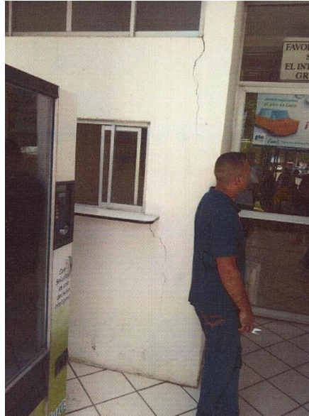
SE OBSERVAN GRIETAS EN MUROS DE FACHADAS Fuente: Dictamen de estructuras 2019
